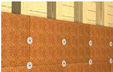
Fissaggio di pannelli isolanti in fibra di legno su struttura in legno massiccio.
